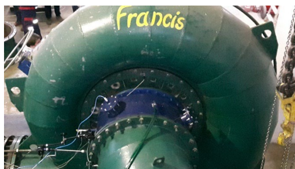
Fig. 2. Dispozitivul de aerare ECOTURB (albastru) în funcțiune pe turbina hidraulică de tip Francis
